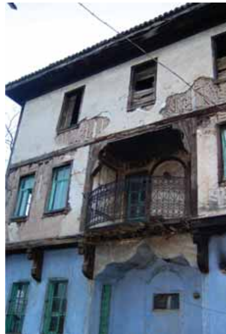
1. Une maison en pan de bois en enduit de chaux à Afyon.
