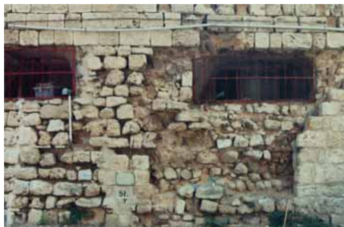
Désordres aux murs.
