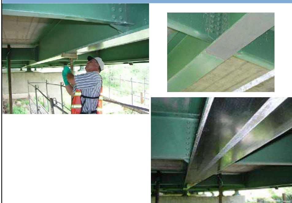
Renforcement des poutres en acier d'un pont mixte par collage de bandes de PRFC
